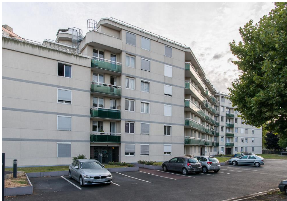
État 2017. Mouvement de la façade. Photo Arnaud Lesné.
